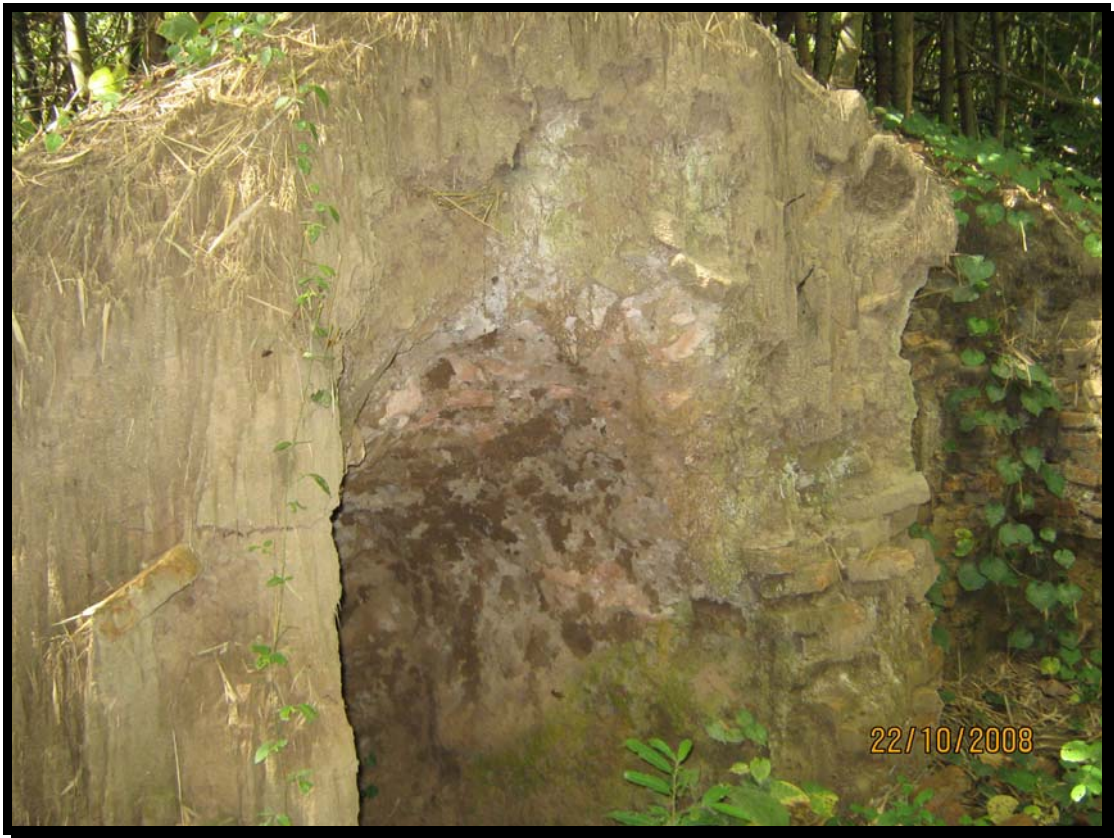
ฐานซุกชีพระประธานในวิหารหลวง ถูกคนขุดทำลาย
